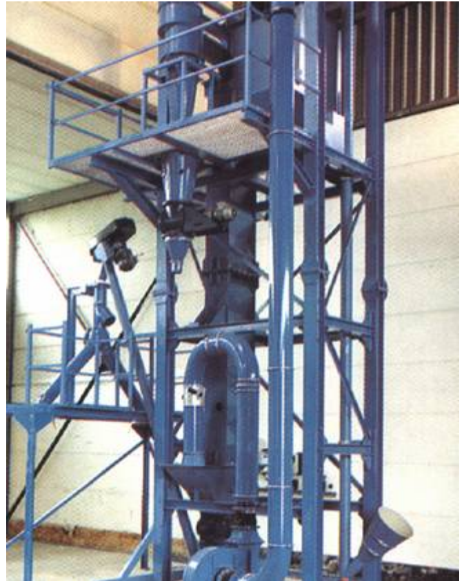
Beispiel einer Umluft-Sichteranlage
